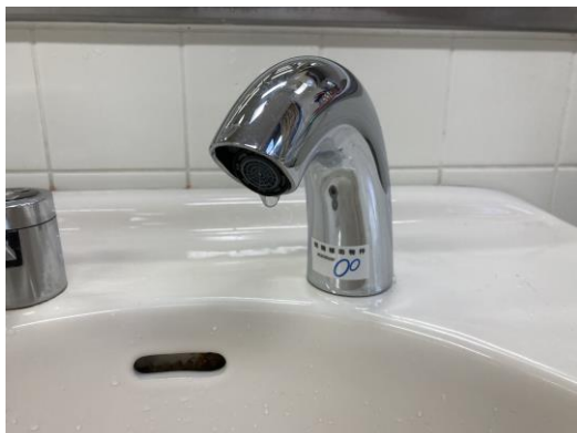
温水自動水栓設備
